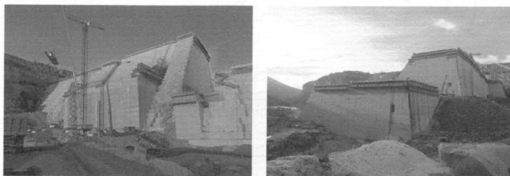
Fotografia 3.24 – Aproveitamento hidroeléctrico de Laúca
