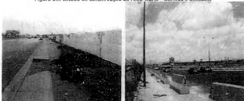
Figura 95: Estado de conservação da rede viária - bermas e acessos.
