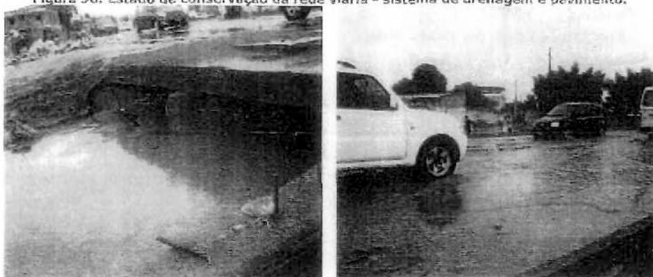
Figura 96: Estado de conservação da rede viária - sistema de drenagem e pavimento.
